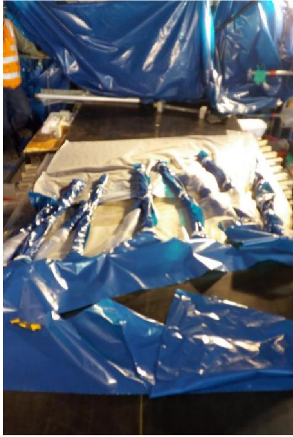
Figura N° 18: Protección del área
