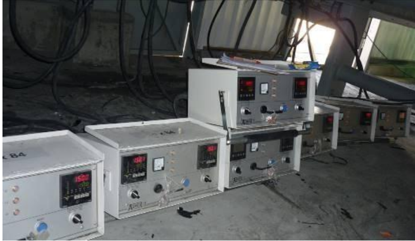
Figura N°27: Tableros de control de temperatura
