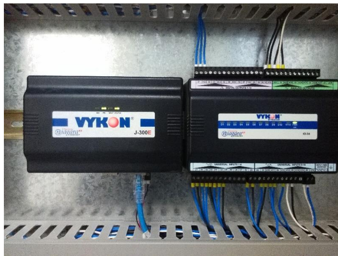
Figura N°5.1 CONTROLADOR Y MÓDULO DE EXPANSIÓN
