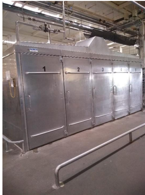
FIGURA N°4.5 CÁMARA DE VAPOR DE PANES
