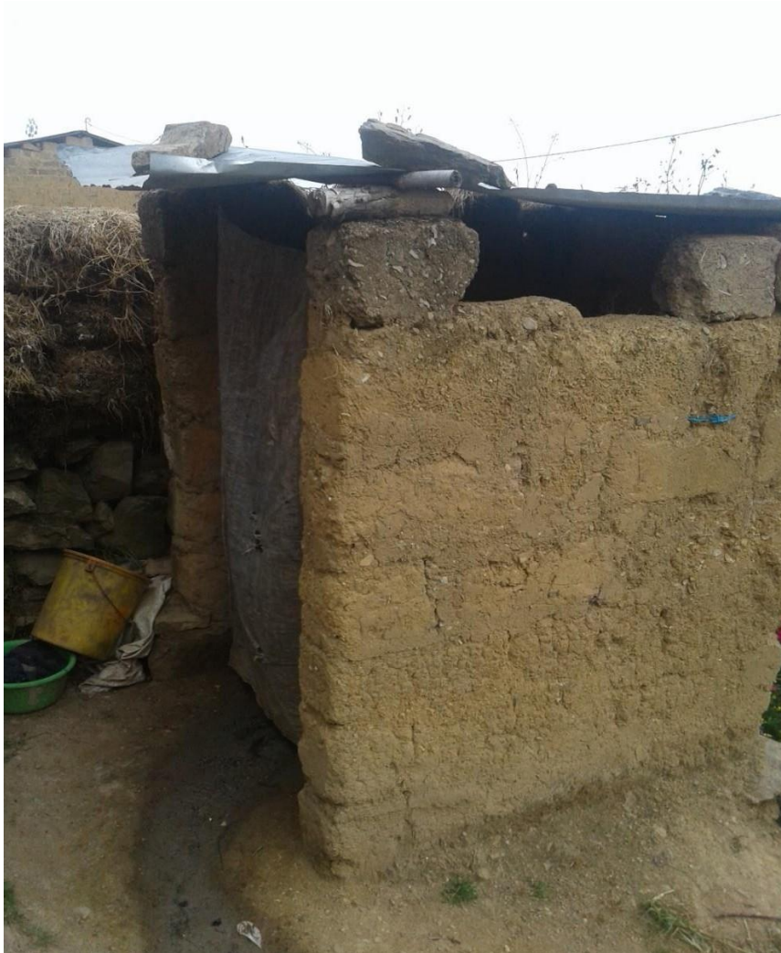
IMAGEN 1: LETRINAS QUE ANTES UTILIZABAN LOS POBLADORES DEL DISTRITO DE VILCABAMBA – GRAU.
