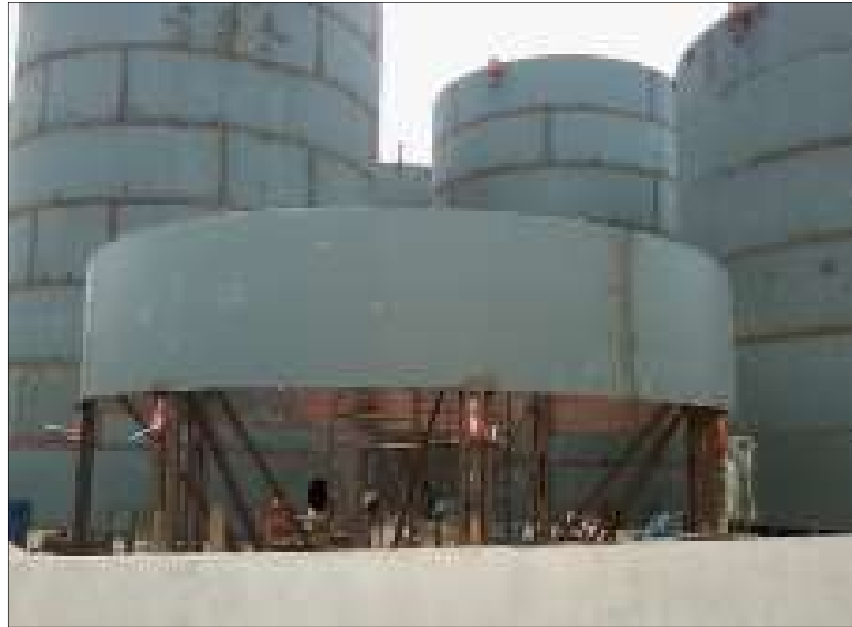
Figura 28 Anillo superior suspendido por gastas hidráulicas.
