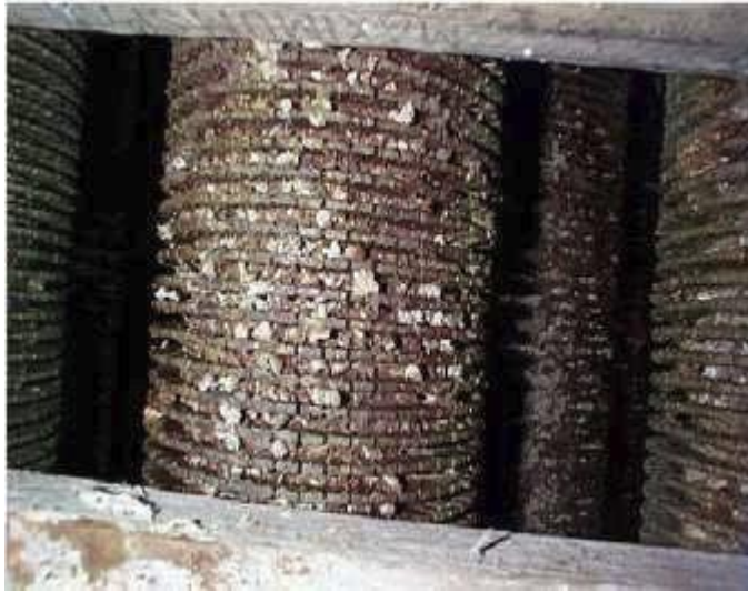
Fig. N° 18: Tubos aletados segmentados después de limpieza Fuente: UOP Honeywell Company. Fired Heaters 2007.
