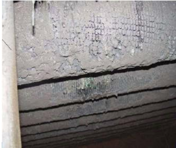
Fig. N° 17: Nivel de ensuciamiento tubos aletados segmentados Fuente: UOP Honeywell Company. Fired Heaters 2007.
