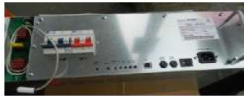
Rectificador - Cargador de baterías UP
