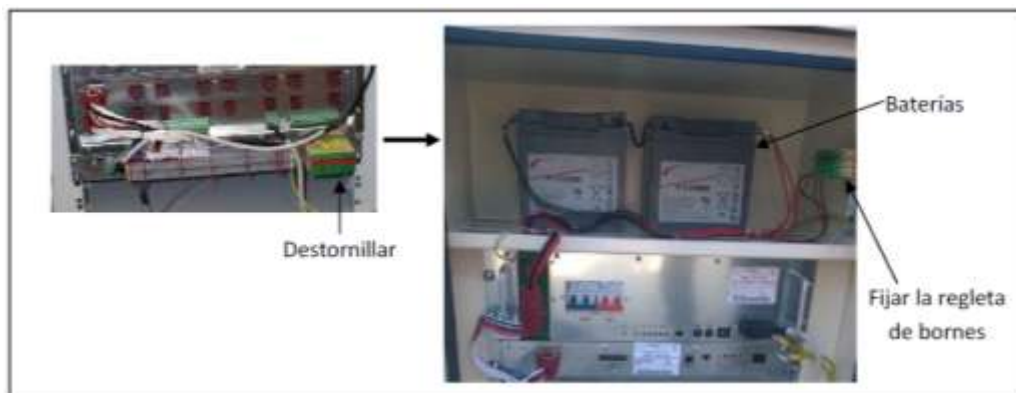
Figura N° 13 - Conexión de baterías
