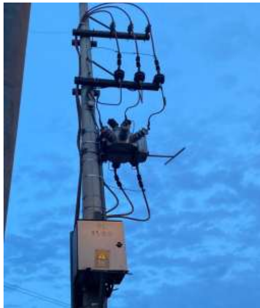
Figura 2. Seccionador bajo carga y transformador de tensión
