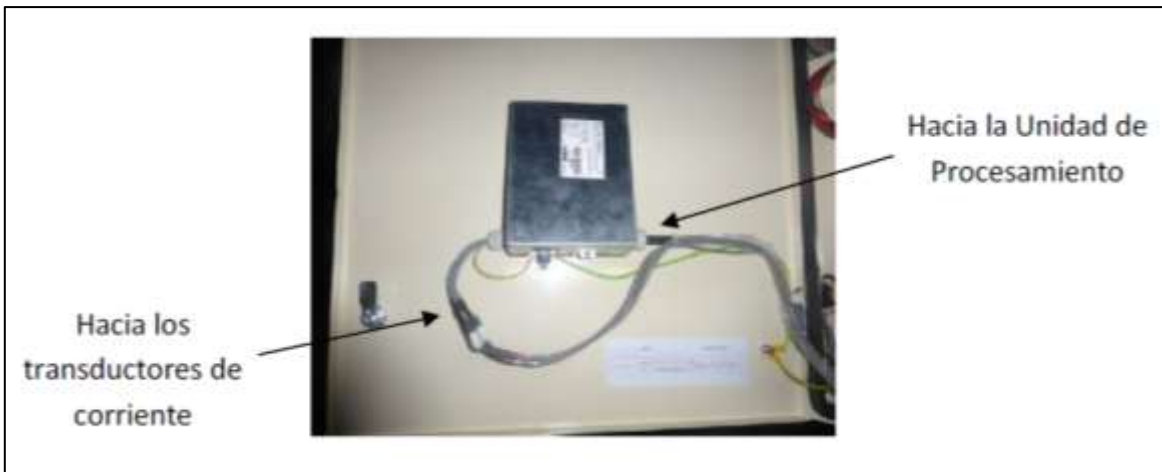
Figura N° 18 - Conexión del RGDAT a sistema de puesta a tierra
