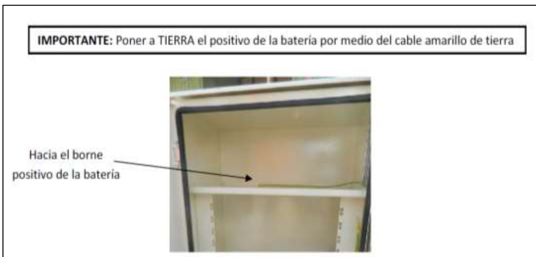
Figura N° 15 - Conexión a sistema de puesta a tierra
