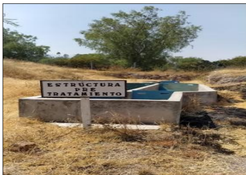
Sistema de entrada del afluente
