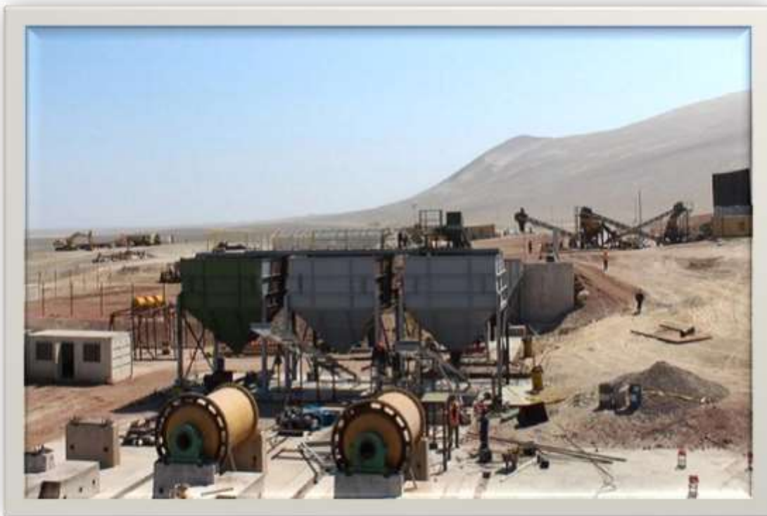
Figura 2 Circuito de Chancado de mineral Koricancha Joint Venture – Oficinas Administrativas de Koricancha Joint Venture
