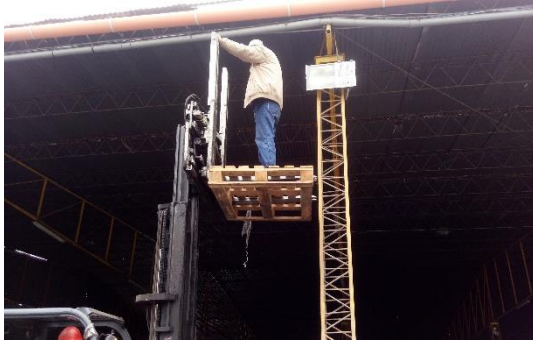
A2: Los trabajadores de otras áreas utilizaban el montacargas para subir a cualquier altura.
