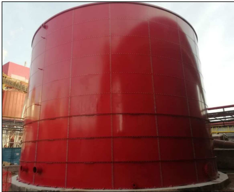
Figura 2.7 Tanque de almacenamiento vertical de acero
