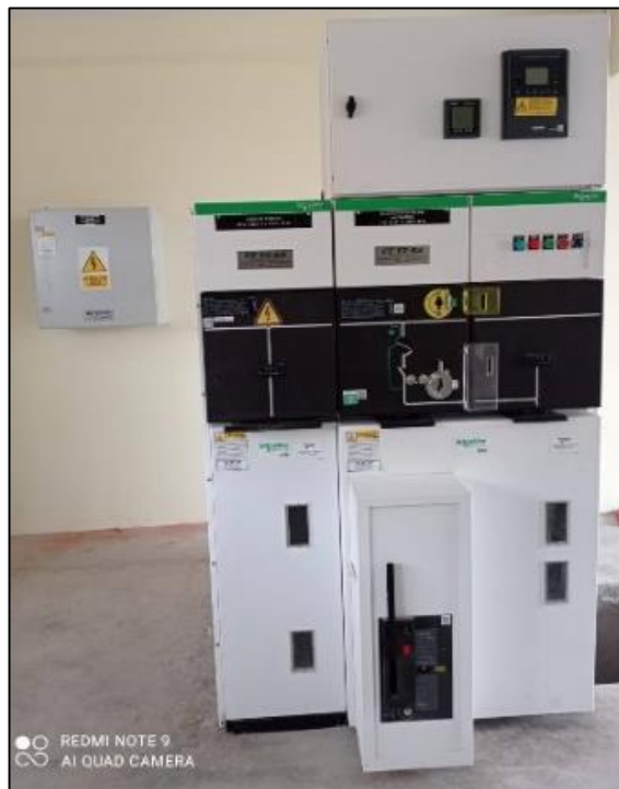
Figura 2.4 - Celda de Llegada o Remonte y Celda de Protección
