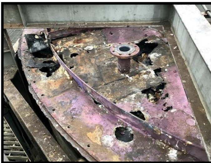
Figura 14. Rotura de cubierta de plomo en techo de EFH
