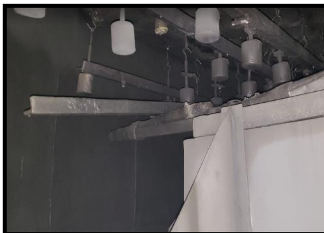
Figura 13. Rotura de ángulo de bastidor inferior del EFH
