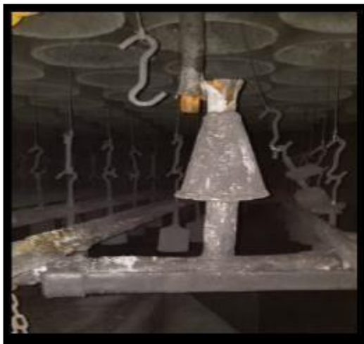
Figura 9. Rotura de soporte inferior del EFH
