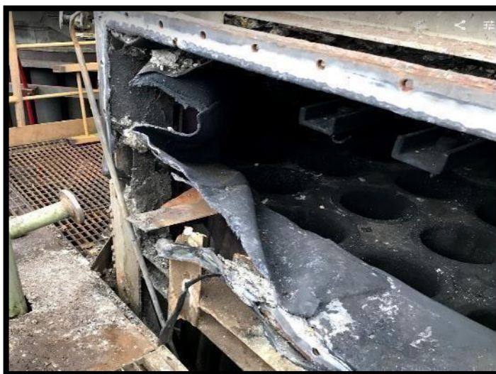
Figura 15. Rotura de cubierta en ducto de salida de EFH
