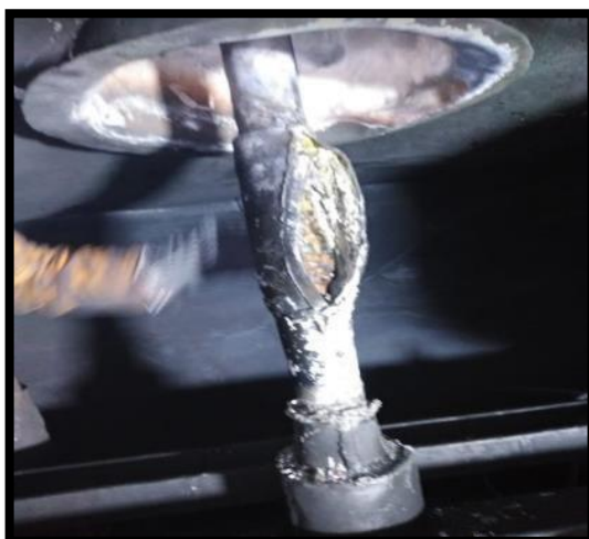
Figura 10. Rotura de soporte superior del EFH
