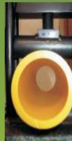
Comportamiento de la tubería antes del desarrollo de la prueba
