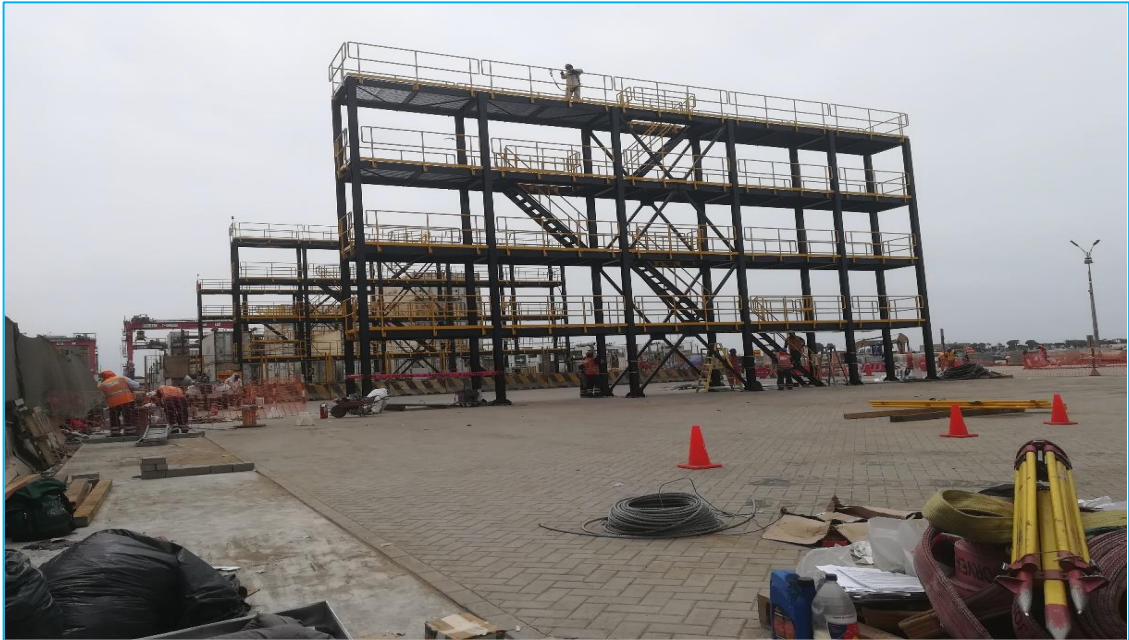
Imagen 10: Plataforma Metálica (REEFER RACK) instalada en DP WORLD
