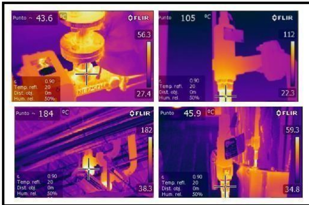
Figura 29 Tomas termográficas de válvulas de alivio de presión.
