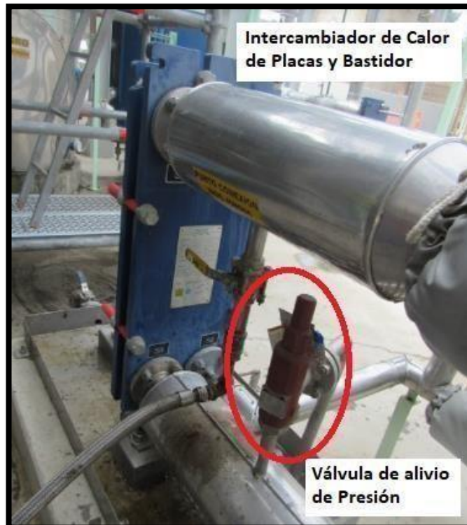
Fotografía 7 Intercambiador de Calor de Placas y Bastidor.
