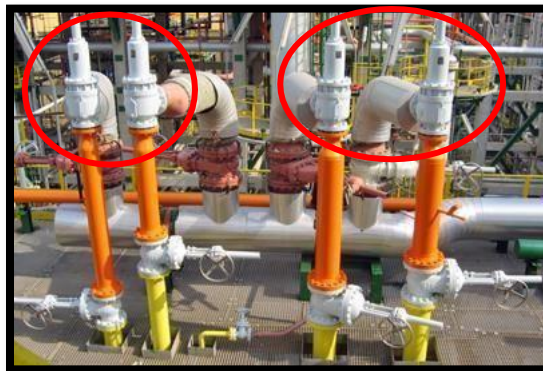
Figura 2 Válvulas de Seguridad en una planta Industrial.
