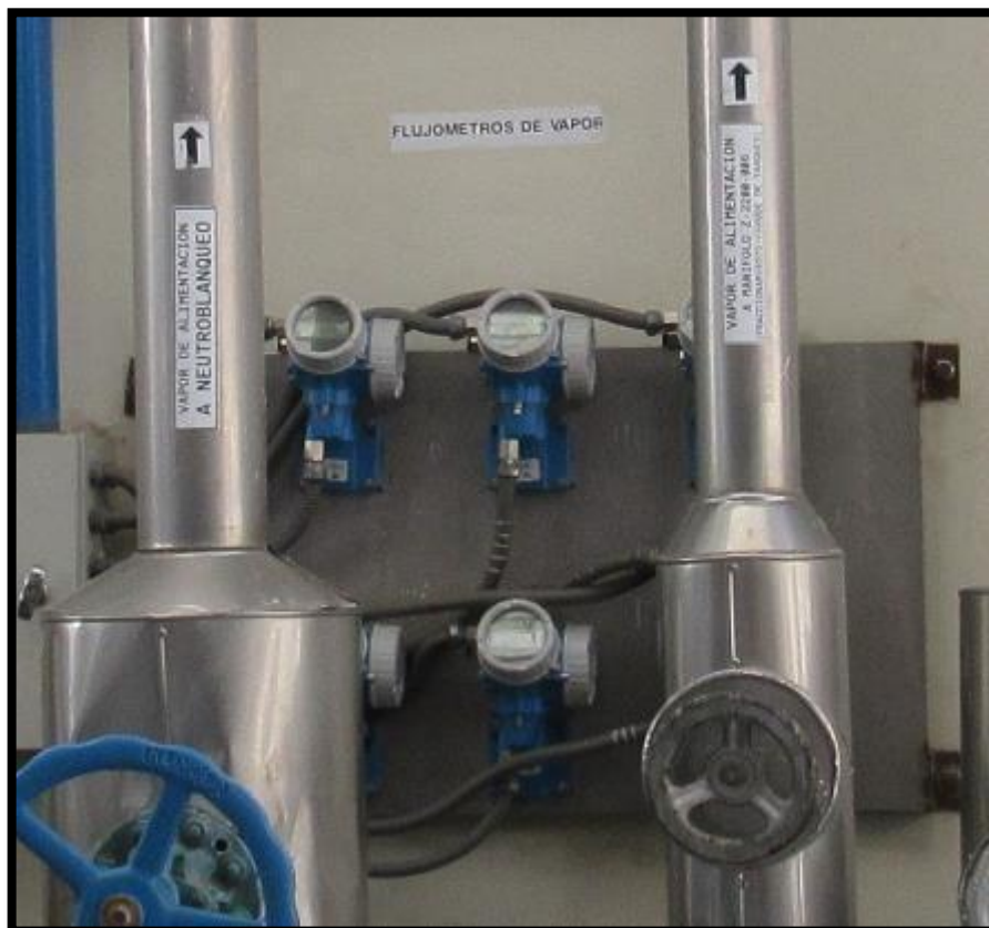
Fotografía 14 Panel de Flujómetros de Vapor - Troncal Principal.
