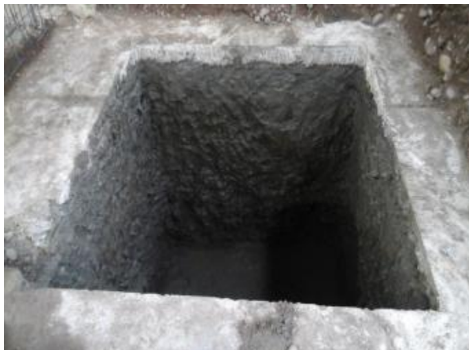
Tanque cisterna ubicada en la zona 1
