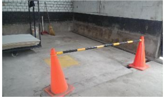
Tanque cisterna en la zona 1
