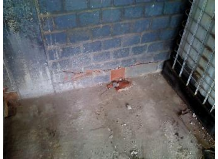
Pisos en condiciones inadecuadas que podría filtrarse sustancias químicas al suelo
