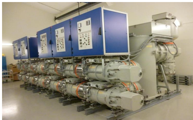
Figura 3. Interruptor de subestación tipo GIS
