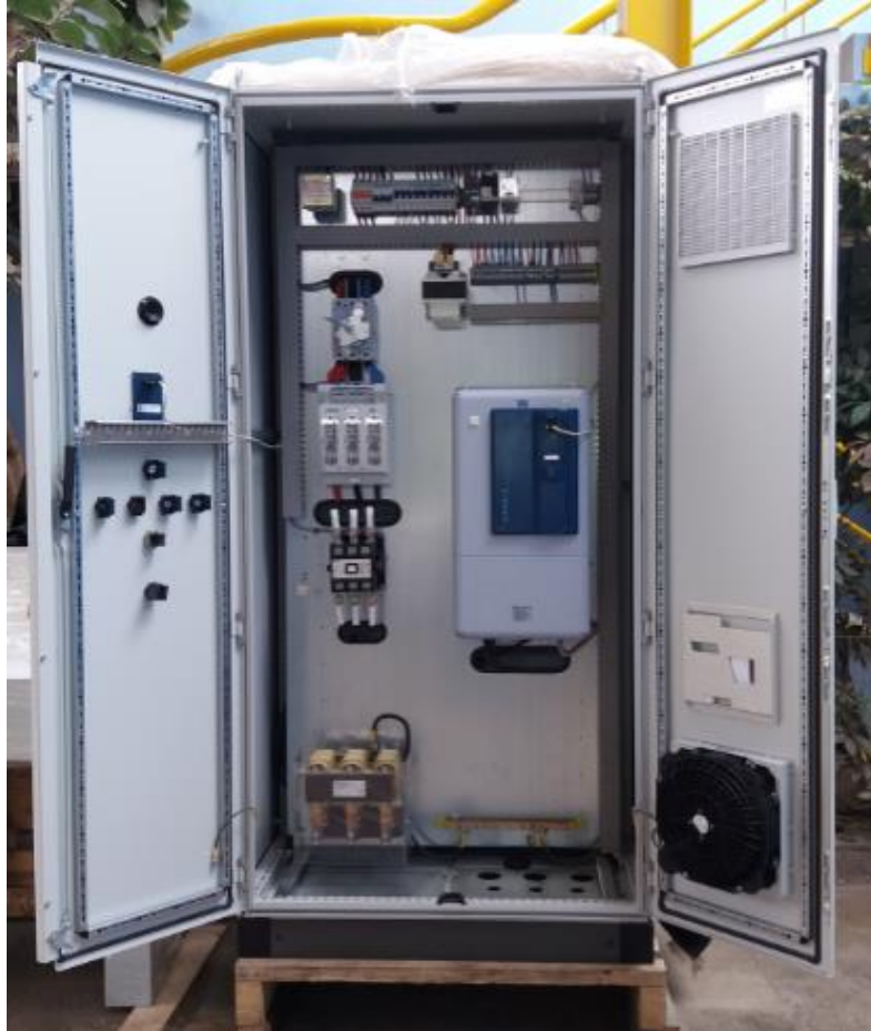
Fuente propia Variador de velocidad
