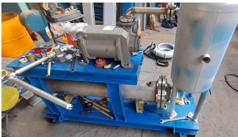
Figura 3.8 Estructura metálica del sistema de vacío.
