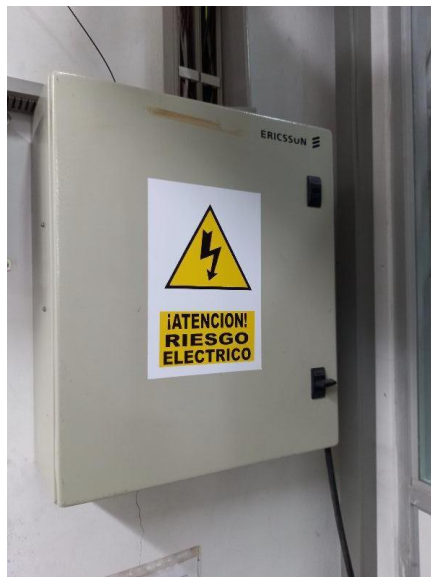
Figura 3.9 – Tablero de Rectificadores – Ericsson (54)
