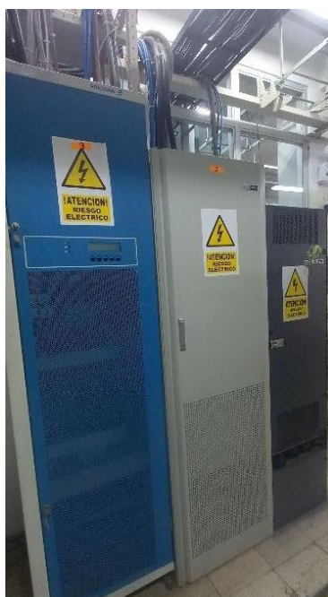
Figura 3.11 – Gabinetes alimentados por el tablero de rectificadores (56)
