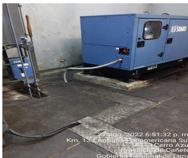
Figura 2.8 – Grupo Electrónico para estación Ihuanco (20)
