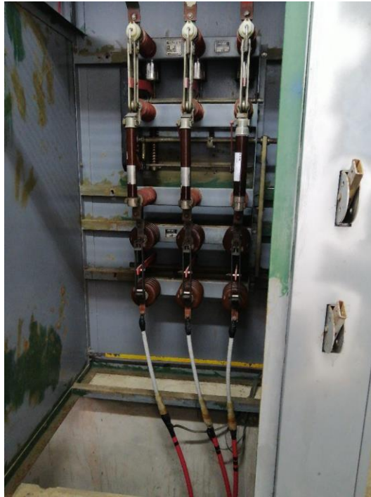
Figura 3.2 – Celda de llegada en Subestación eléctrica (47)
