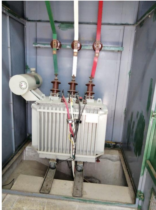
Figura 3.3 – Transformador de 100KVA en Subestación eléctrica (48)
