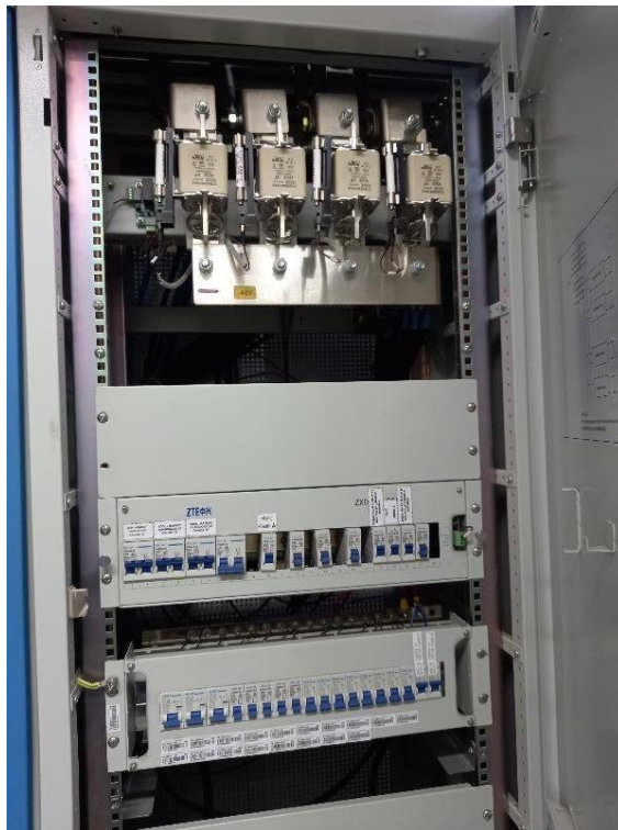
Figura 3.14 – Bastidor de distribución DC (59)
