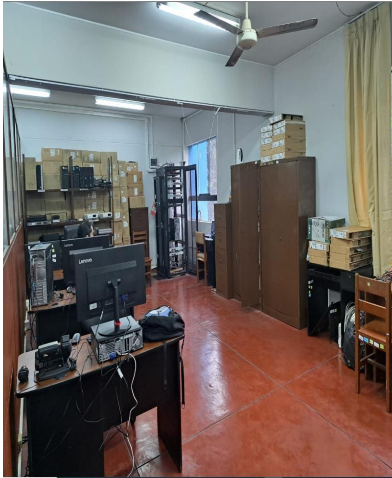
Figura 6: Área del servidor
