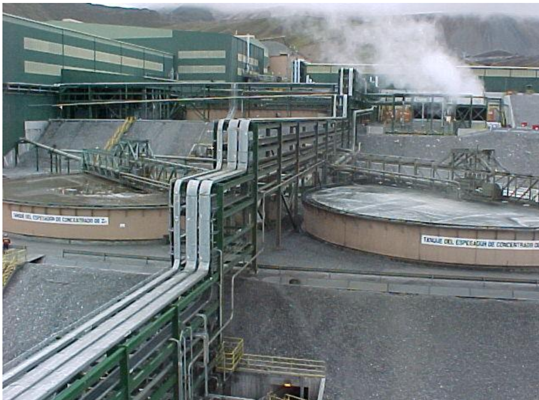
Figura N° 2.6 TANQUES ESPESADORES DE CONCENTRADO DE COBRE Y ZINC.
