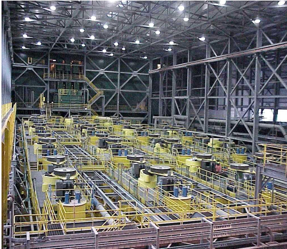
Figura N° 2.3 CELDAS DE FLOTACIÓN DE COBRE.
