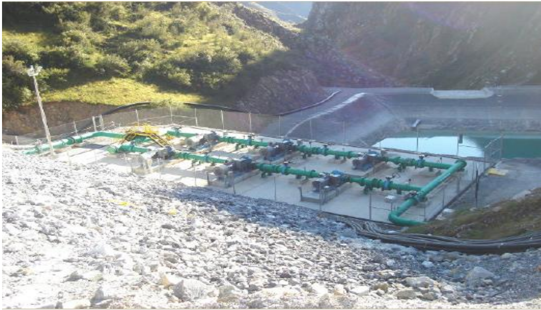
Figura N° 2.48 VISTA DE LA BOMBAS DEL SISTEMA DE REBOMBEO
