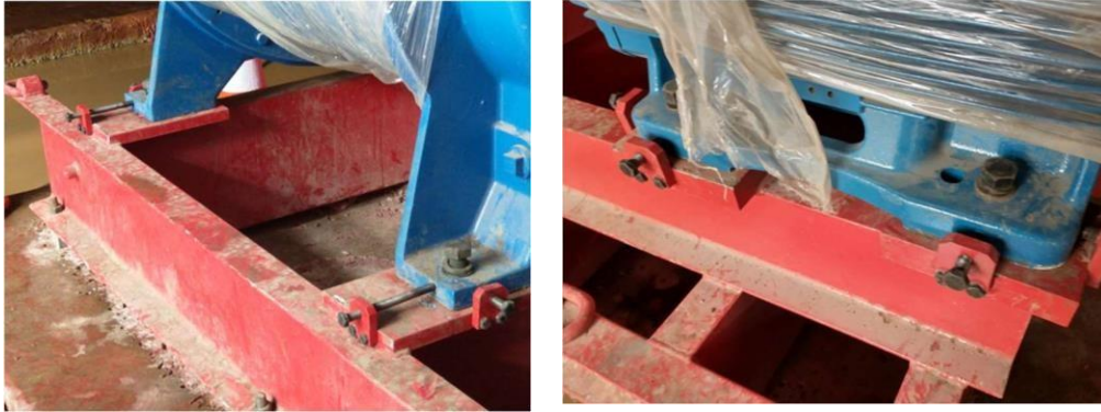
Figura 3.34 alineamiento de bomba
