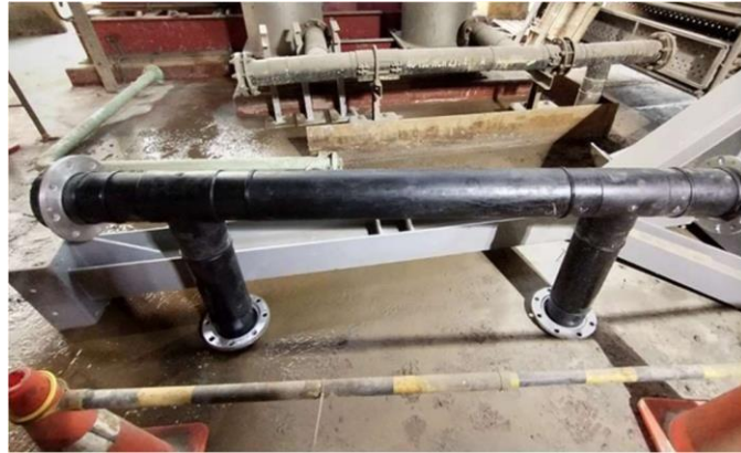
Figura 3.18 tubería en HDP
