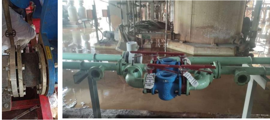
Figura 3.45 Conexión de la línea de agua inoxidable
