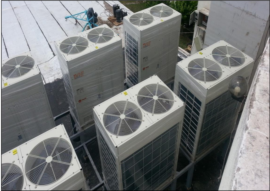
Figura 4.8 UNIDADES EXTERIORES DE VOLUMEN DE REFRIGERANTE VARIABLE ENFRIADAS POR AIRE
