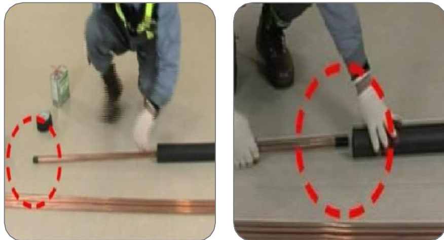
Figura 4.33 AISLAMIENTO DE TUBERIAS
