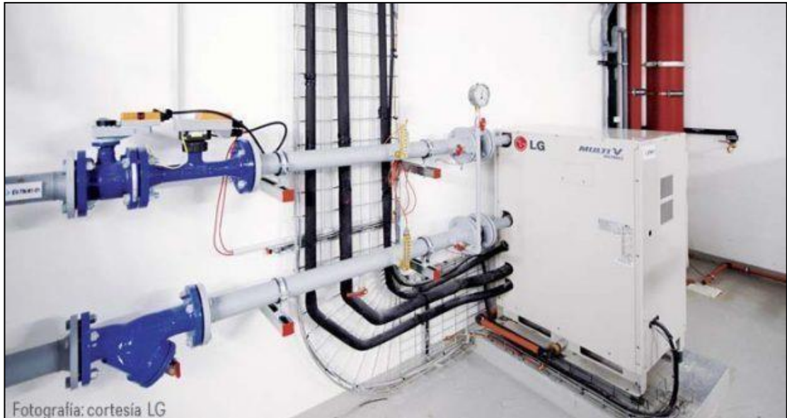
Figura 4.9 UNIDADES EXTERIORES DE VOLUMEN DE REFRIGERANTE VARIABLE ENFRIADAS POR AGUA
