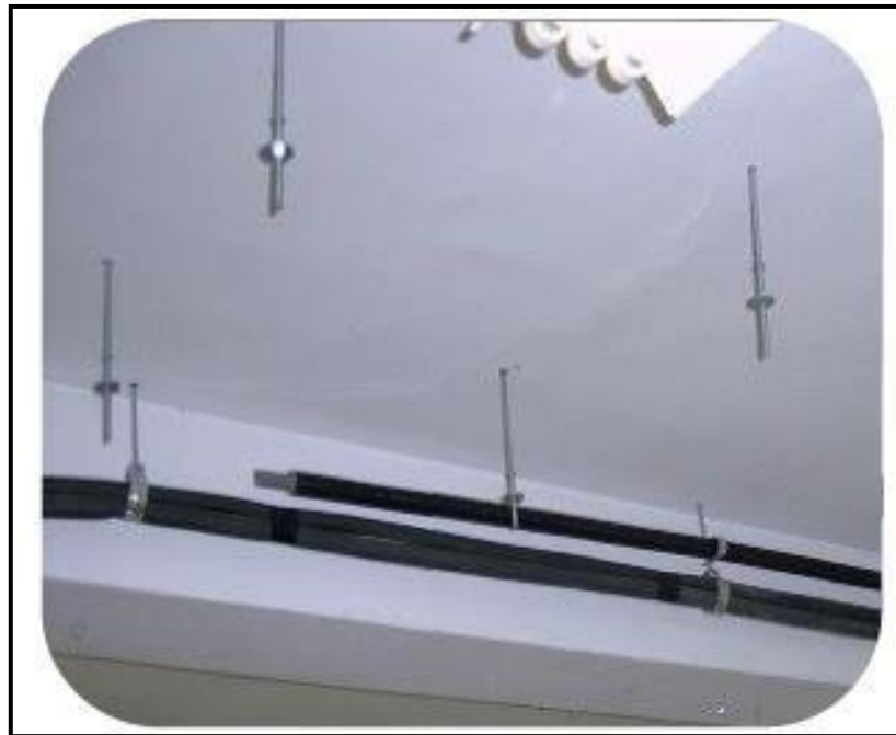
Figura 4.42 MARCADO CON LA PLACA GUIA DE LOS EQUIPOS
