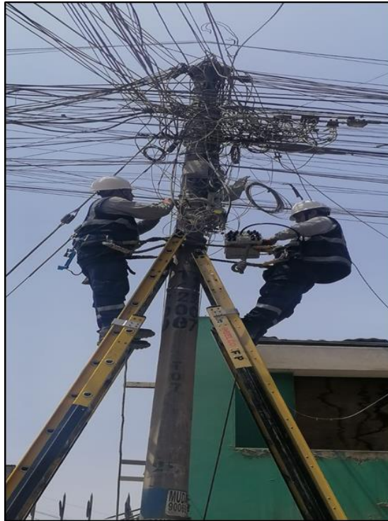
Figura 11. Evidencia del tendido aéreo de fibra óptica
