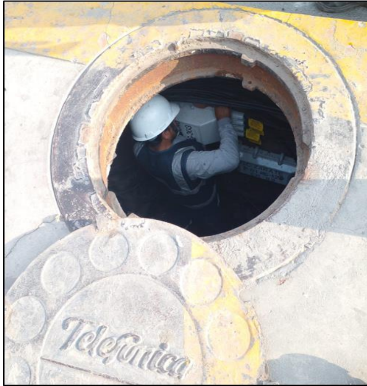
Figura 9. Canalización existente de fibra óptica
