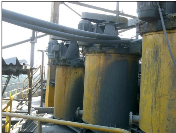
Figura 2.38 Súper acondicionador Pb- Cu (3) (A3)
