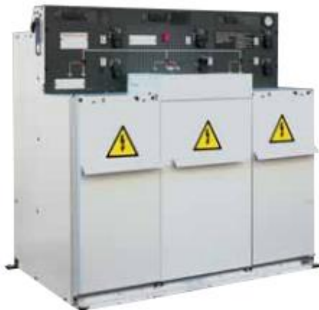
Figura 9. Imagen de las celdas RM6 – SCHNEIDER ELECTRIC.
