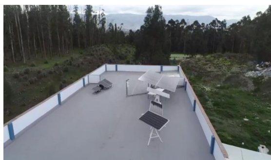
VISTA PANORÁMICA DE LOS SEGUIDORES SOLARES
