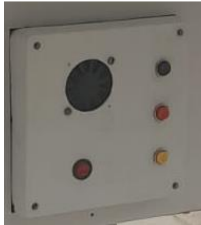
Figura 40. Panel de control del seguidor astronómico
