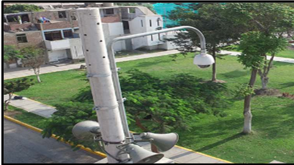
Figura 7 Cámaras de vigilancia
