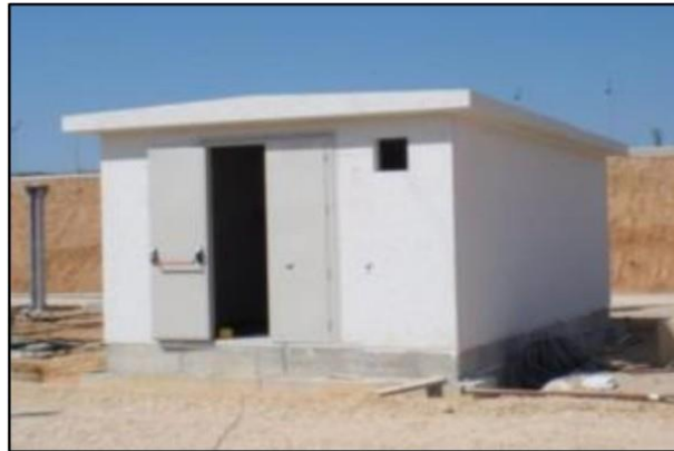
Figura 8, Subestación de Distribución Convencional
