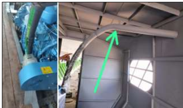
Figura 3.15. Tubería y manguera para desfogue de gases del cárter
