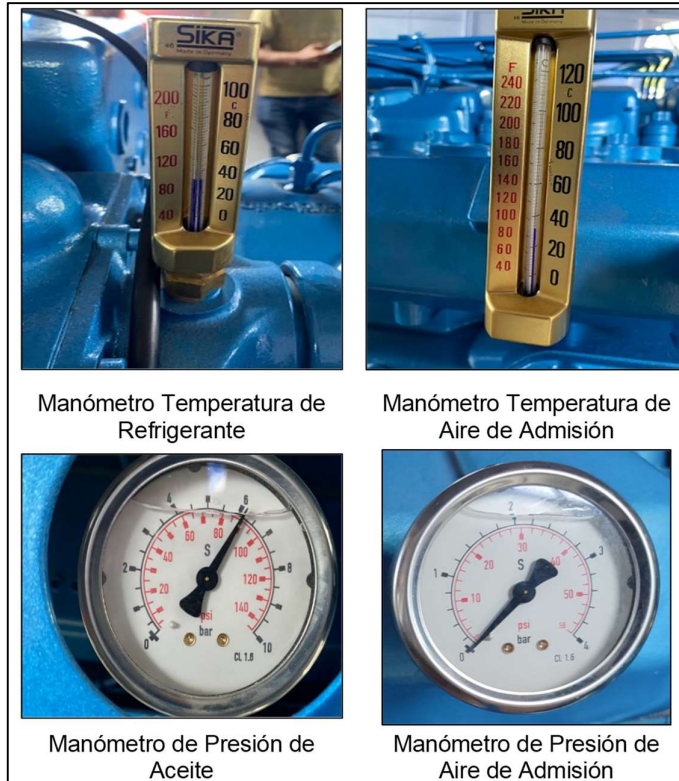
Figura 3.16. Manómetros de presión y temperatura
