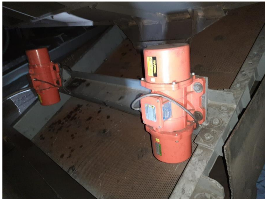
Figura 4.22 fin de ensamblaje de zaranda en planta
