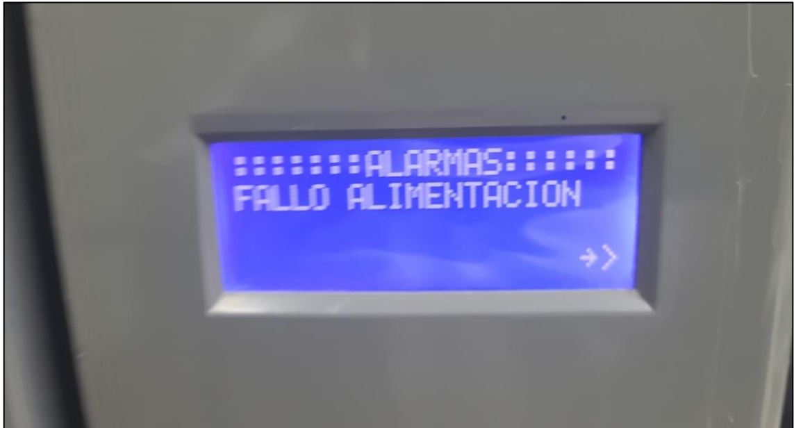
Figura N° 28. Alarma FALLO ALIMENTACIÓN
