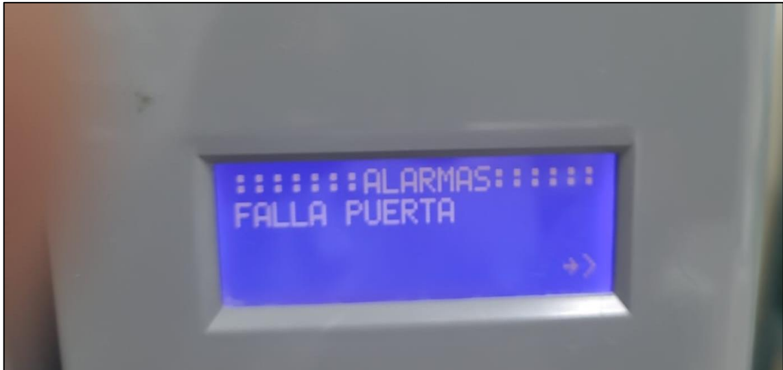
Figura N° 26. Alarma de FALLA PUERTA
