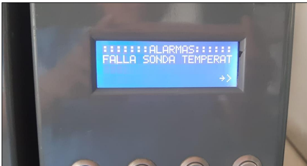
Figura N° 27. Alarma FALLA SONDA TEMPERATURA
