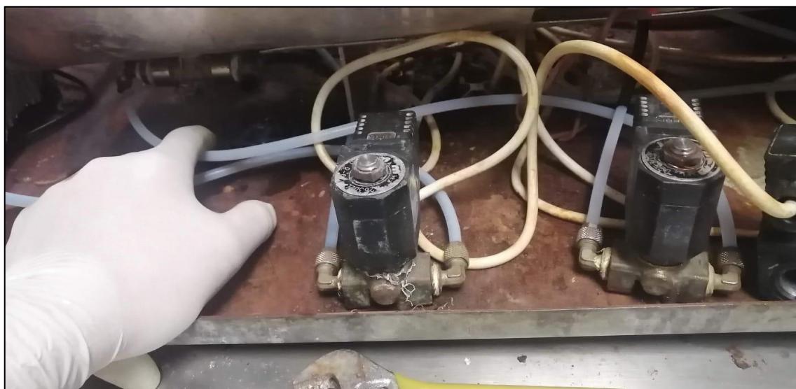
Figura N° 48. Limpieza de válvulas solenoides
