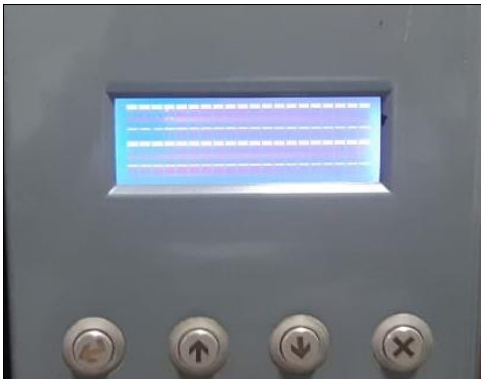
Figura N° 30. Falla en la pantalla de control Fuente: Elaboración propia
