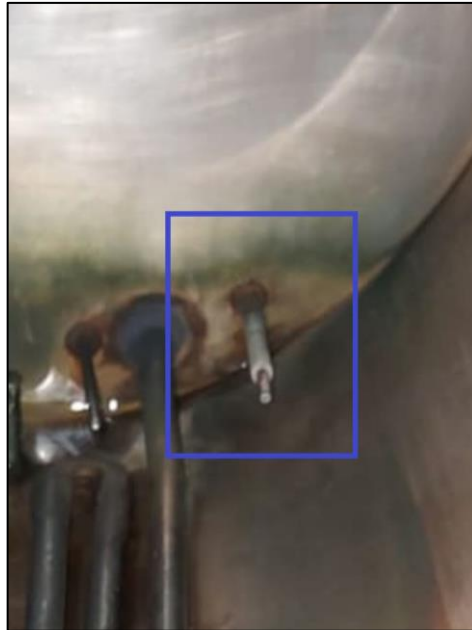
Figura N° 54. Cambio del sensor de nivel de agua
