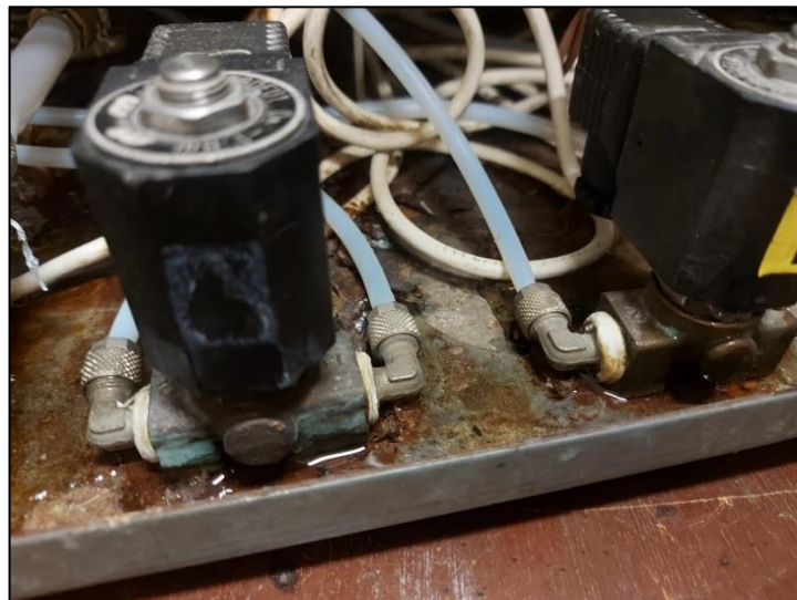
Figura N° 45. Fugas en las tuberías por filtración de líquido Fuente: Elaboración propia
