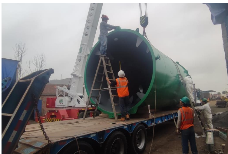
Figura 4.28 Despacho de tanque de neutralización
