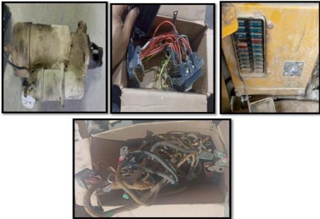
Figura 4.9 Conjunto de Fallas Sistema Eléctrico.
