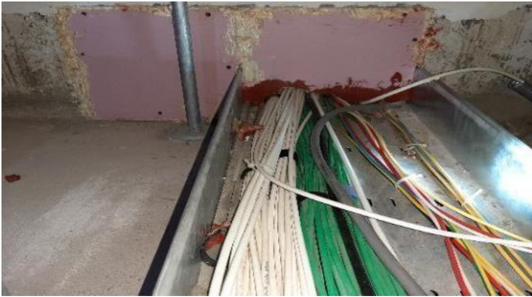
Figura 3.2 Bandeja electrica y de señales 3er piso
