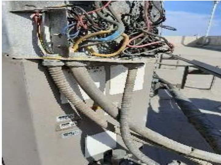
Figura 3.8 Compresor de aire del 3er piso
