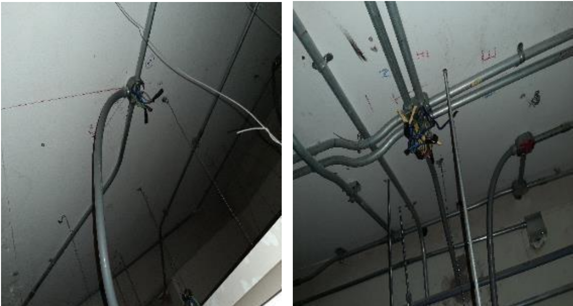
Figura 3.3 Instalaciones en falso cielo 3er piso
