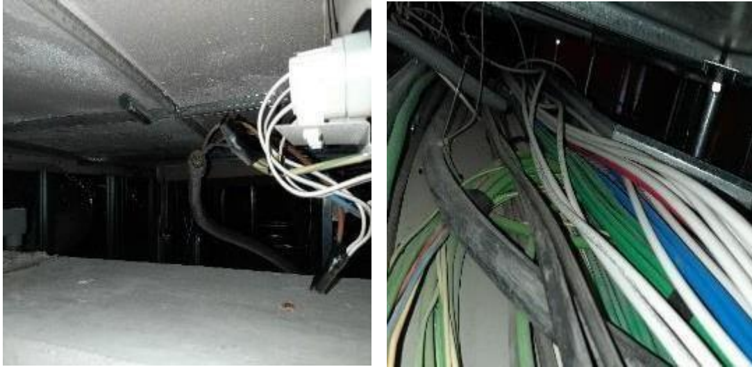
Figura 3.6 Bandeja electrica y de señales 4to piso
