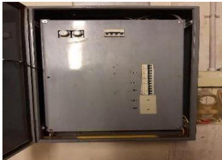
Figura 3.5 Tablero de alumbrado 4to piso
