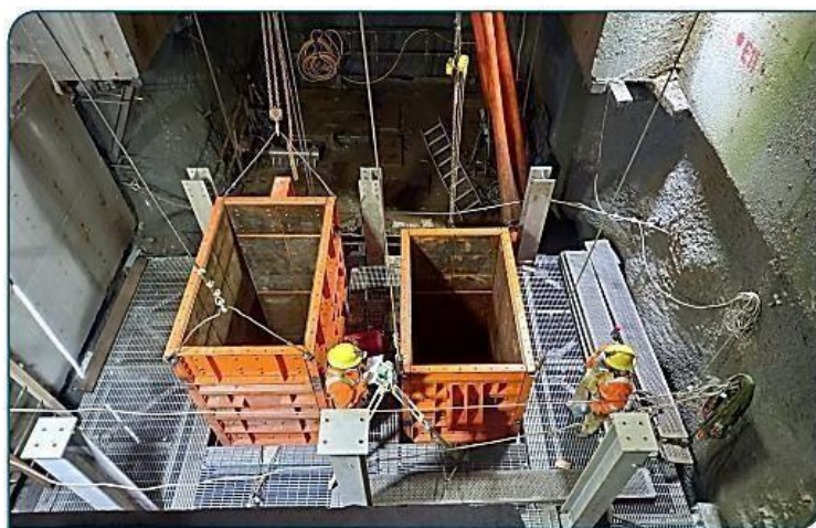
Imagen 2.7 Plataforma de mantenimiento e inspección del nivel 9 del spill and loading pocket
