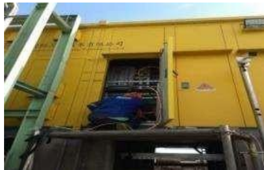
Figura 3.23. Conexion de Equipo Shelter - Sala Eléctrica planta desaladora (17)
