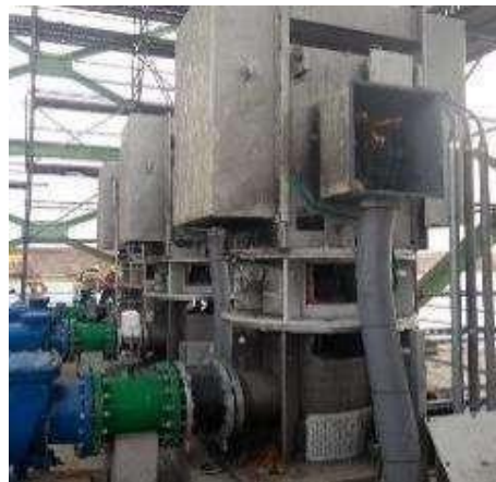
Figura 3.21. Acometida de Fuerza y Control de Bomba vertical (17)
