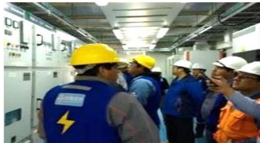
Figura 3.35. Energizado de sala Eléctrica E-HOUSE 1920-100/100A/100B (17)
