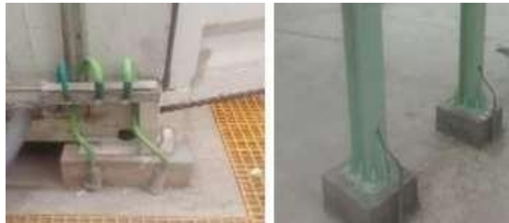
Figura 3.24. Aterramiento de equipos y estructuras en planta desaladora. (17)
