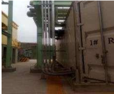
Figura 3.22. Acometida de Fuerza y Control en Planta de tratamiento (17)
