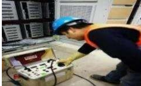
Figura 3.34. Pruebas de Hipot en cables y de MT de Sala eléctrica (17)
