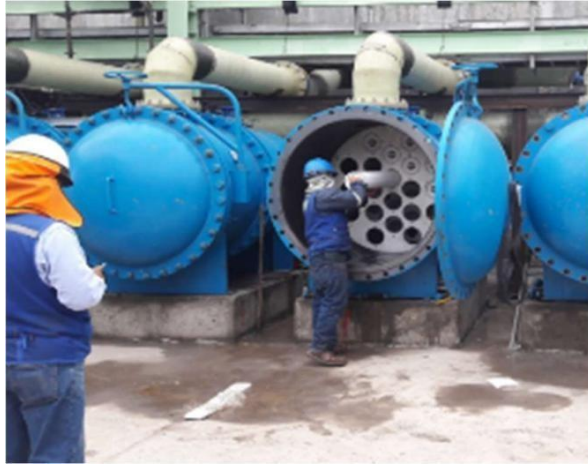
Figura 3.13. Montaje de Filtro autolimpiante Cartucho RO (17)
