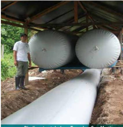
Biodigestor tubular - Tocache, San Martín.
