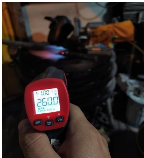
Figura N°21 Lectura de temperatura de Pre calentamiento
