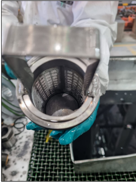
Figura A13. Limpieza de filtro indicador
