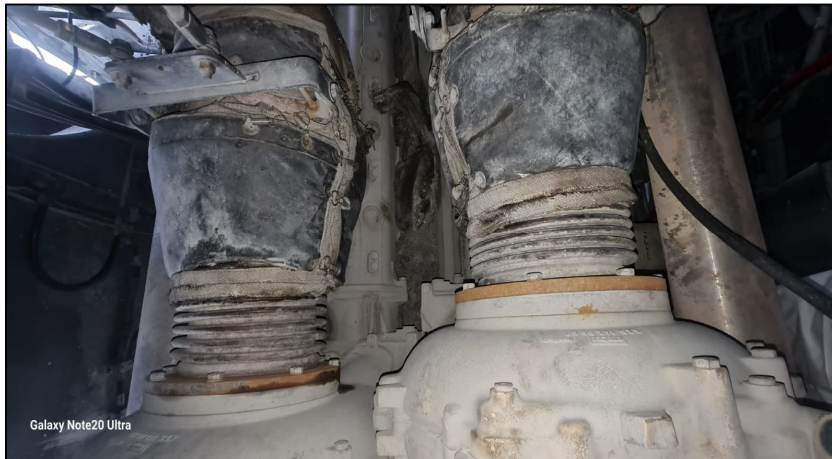
Figura A7. Inspección de Flexibles - Alineamiento 2
