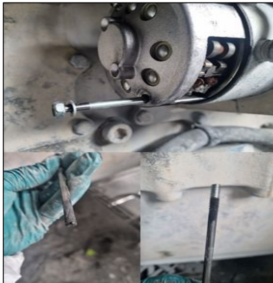
Figura A4. Inspección de Bomba Prelube - Perno roto de sujeción
