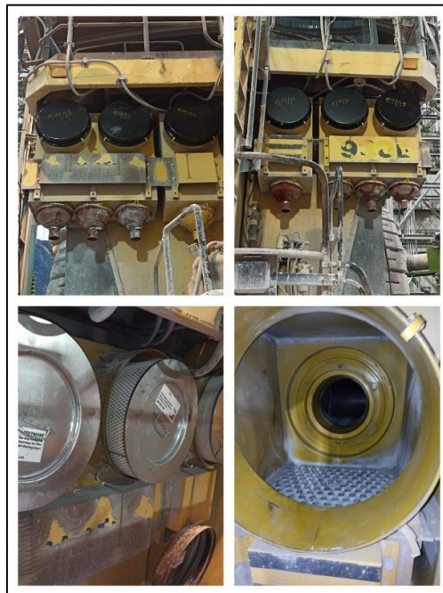
Figura A6. Inspección de Filtros de aire
