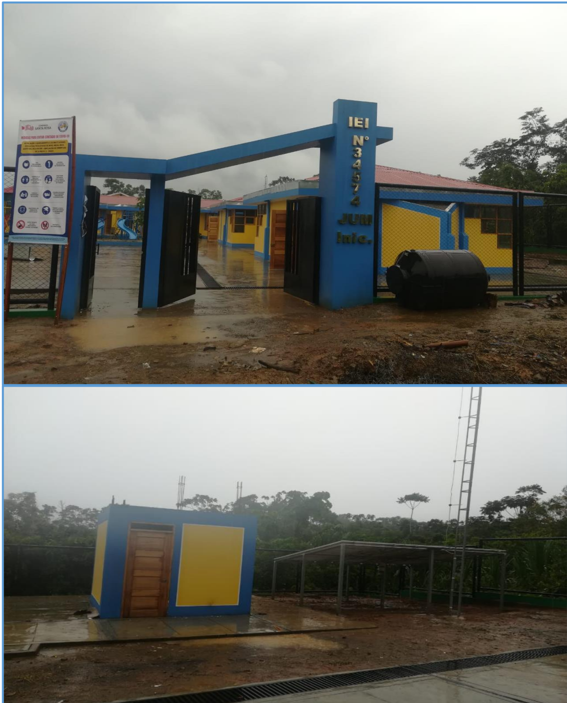
Figura N° 1. Sistema Fotovoltaico Fijo Instalado en la IIEE Nevati Fuente: Elaboración Propia del Autor
