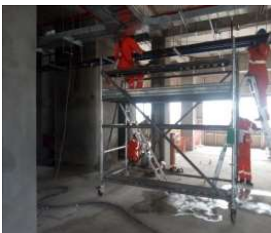
Figura 3. Ejemplo de la instalación de gases medicinales.
