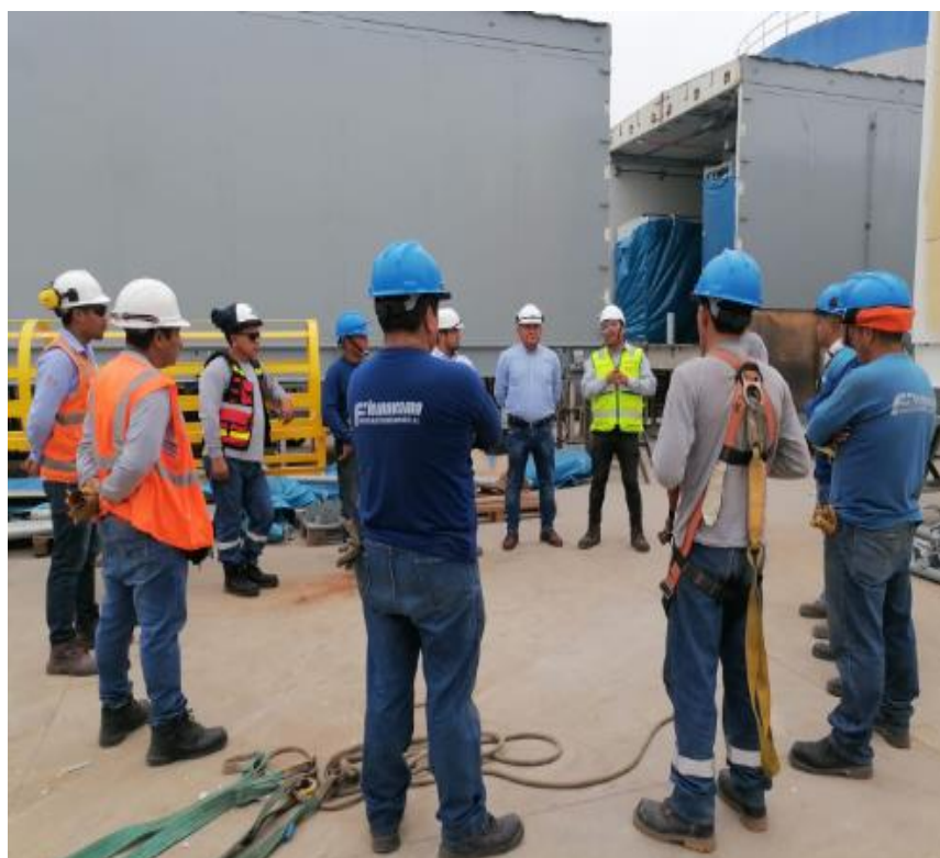
Personal de Verbo Dirección y Gestión de Proyectos S.A.C. antes de iniciar trabajos de altura.
