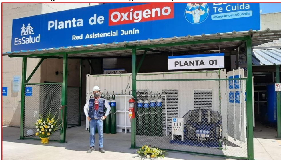
Figura 2.5. “Planta de oxígeno en Hospital Ramiro Priale EsSalud”
