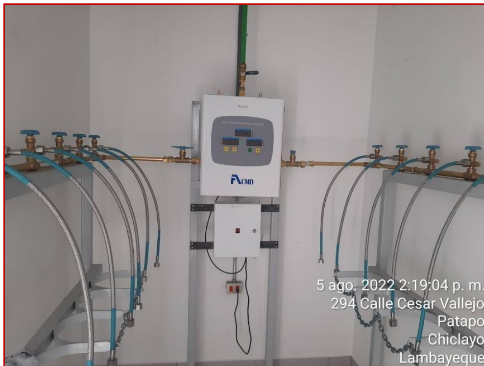
Figura 3.16. Manifold de oxígeno
