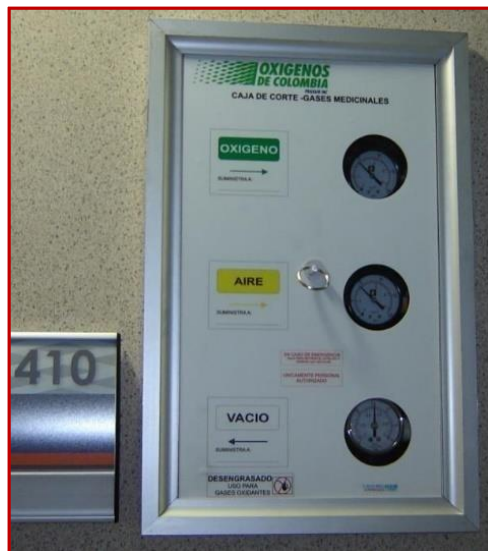
Figura 3.19. Caja de valvulas
