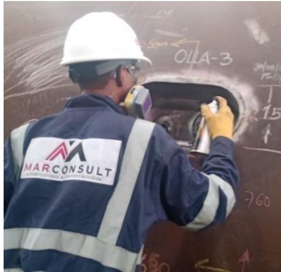
Figura 2.11 Ensayo de líquidos penetrantes a reparación de olla de instrumentación de recipiente a presión para transporte de GLP.
