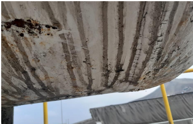
Figura 2.18 Corrosión generalizada debajo de recubrimiento de pintura en recipiente a presión
