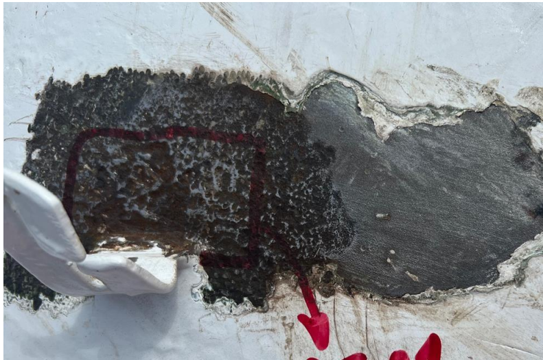
Figura 2.17 Inicio de corrosión localizada en recipiente a presión
