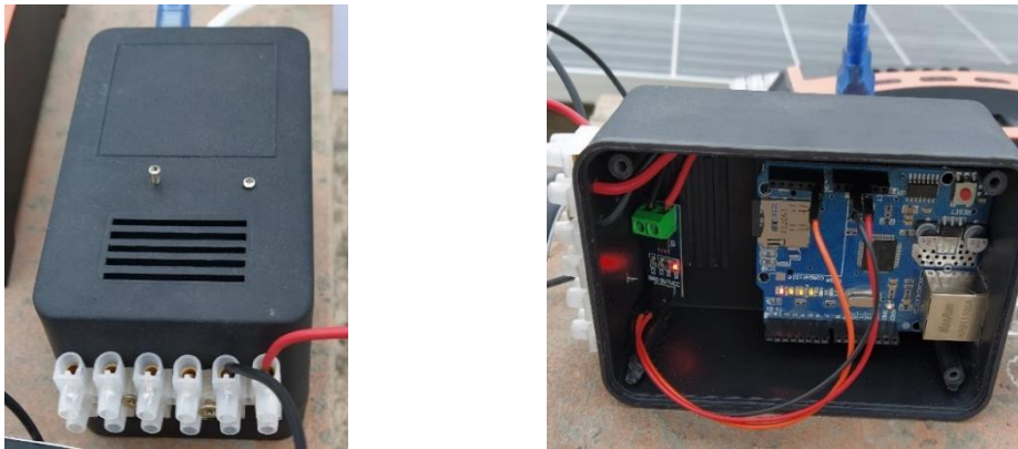
Fig. 20. Controlador Arduino para el sistema de medición. Fuente: implementación propia
