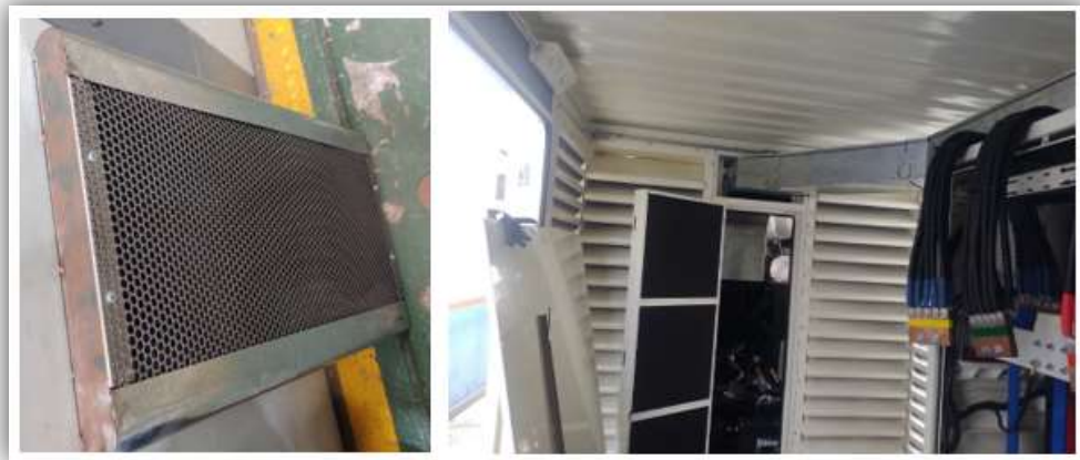
Figura 3.45: Rejillas acústicas entrada de aire
