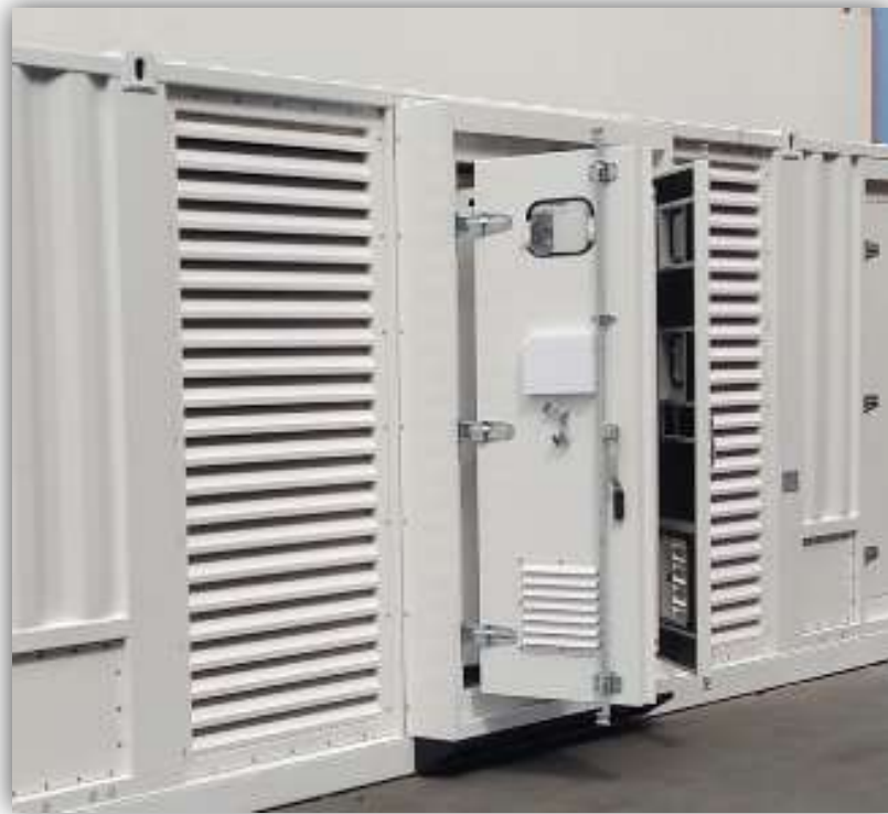
Figura 3.48: Rejillas acústicas entrada de aire a Sala Eléctrica
