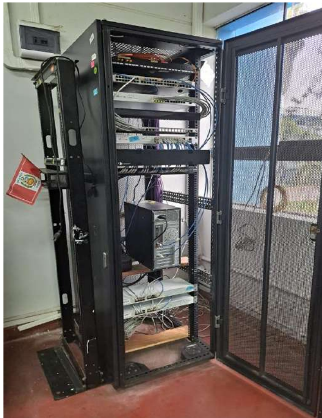
Figura 07: Gabinete Fuente: elaboración propia.
